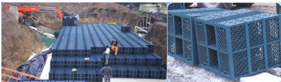
Bassin de rétention des eaux pluviales de 344 m 3 construit au stade Jean Alric à Aurillac (source : AGGLOmag n° 57)
